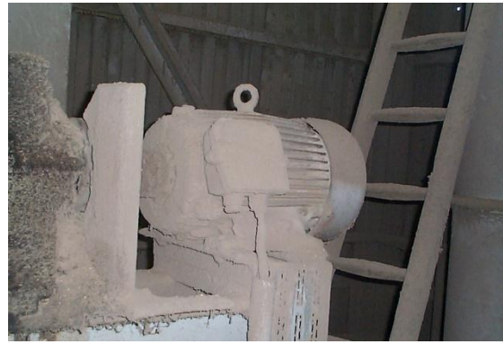
Abbildung 12: Staubablagerungen auf dem Antriebsmotor einer Förderanlage
