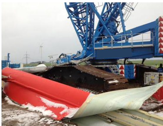
Abbildung 5: Kran und herabgestürztes Rotorblatt Quelle: LAGuS M-V
