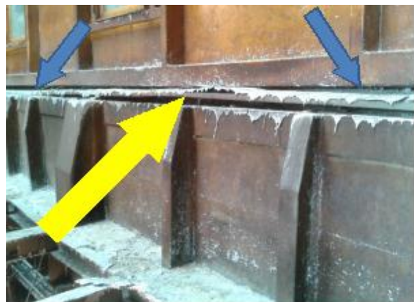
Abbildung 15: Aufwölbung der Oberkante der Zinkbadwanne (gelber Pfeil), Spalt zwischen Wanne und beweglichem Seitenteil der Einhausung (blaue Pfeile), Quelle: LAGuS M-V
