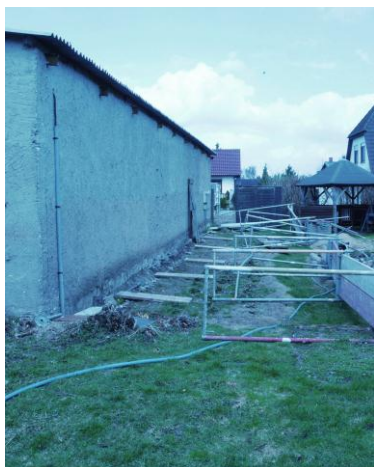
Abbildung 11: umgestürztes Gerüst Quelle: LAGuS M-V
