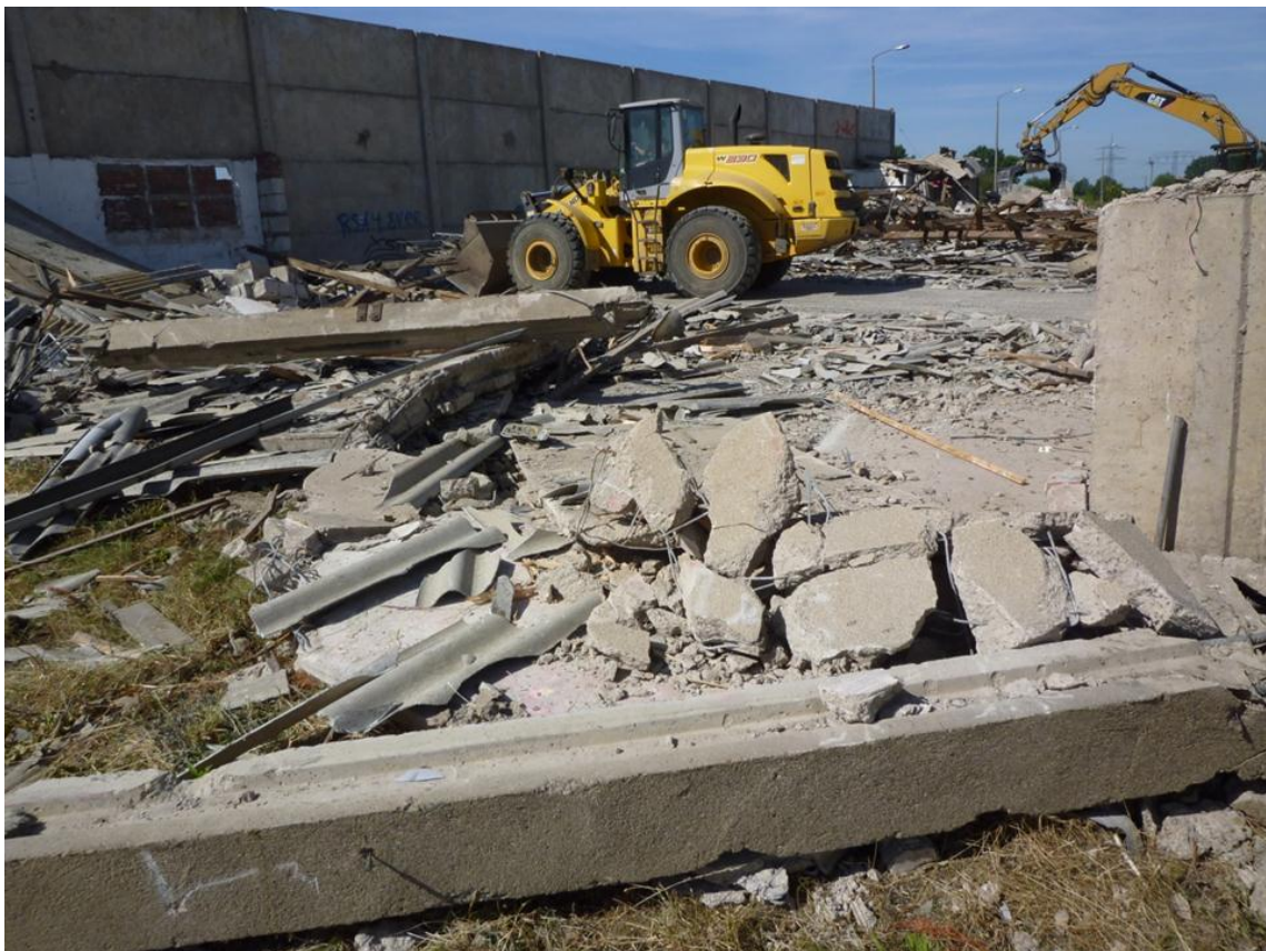
Abbildung 21: Unsachgemäßer maschineller Asbestzementabbruch, Quelle: LAGuS M-V
