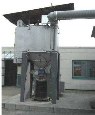
Abbildung 20: Filteranlage Quelle: LAGuS M-V
