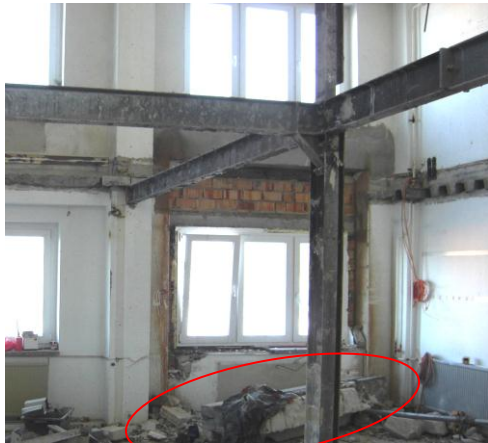
Abbildung 10: herabgestürzter Mauerwerksabschnitt, Quelle: LAGuS M-V
