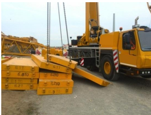
Abbildung 11: verrutschte Ballastgewichte Quelle Abbildungen 11 und 12: LAGuS M-V
