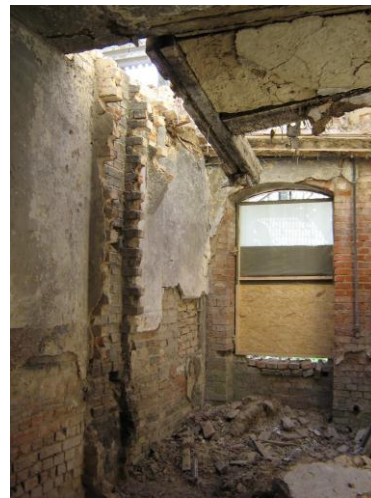
Abbildung 12: eingestürzte Holzbalkendecke im Erdgeschoss
