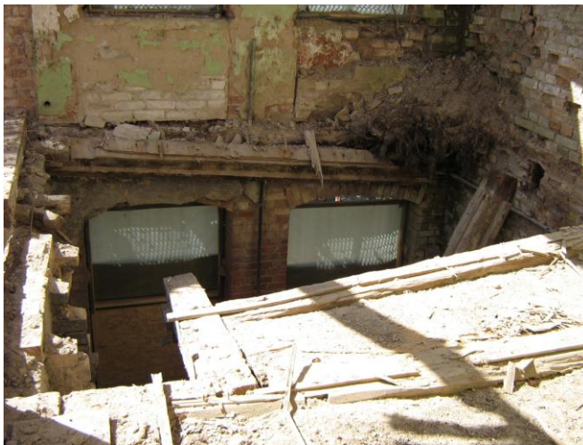
Abbildung 11: eingestürzte Holzbalkendecke im Obergeschoss
