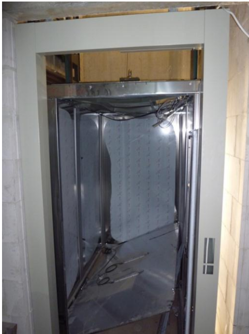
Abbildung 15: Deformierte Aufzugskabine nach dem Absturz, Quelle: LAGuS
