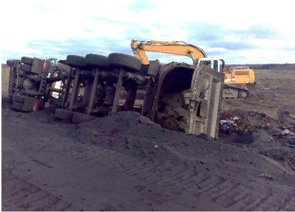
Abbildung 7: in die Baugrube gestürzter LKW, Quelle: LAGuS
