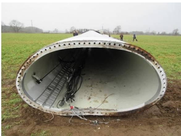
Abbildung 16: umgestürzte Windenergieanlage - korrodierter Flansch Quelle Abbildungen 16+17: LAGuS
