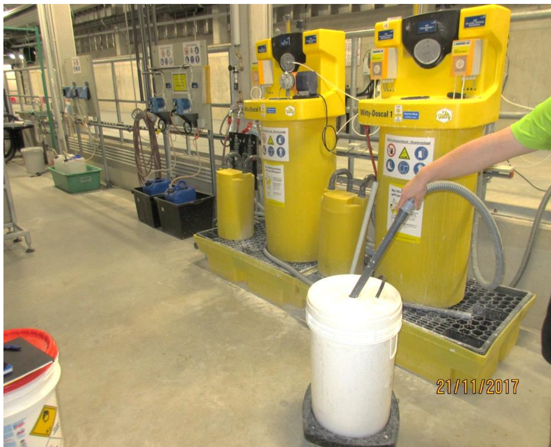
Abbildung 21: Badewasseraufbereitungsanlage einer öffentlichen Schwimmhalle, Quelle: LAGuS
