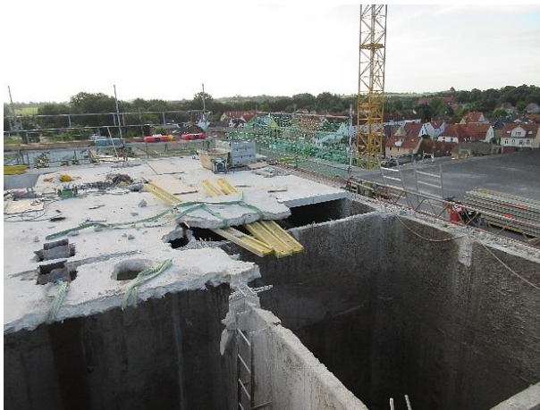
Abbildung 13: Speichersilo mit Resten der Deckenkonstruktion Quelle Abbildungen 13+14: LAGuS
