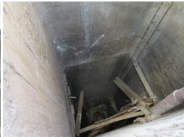
Abbildung 14: Blick von oben in die Silokammer auf die Unfallstelle
