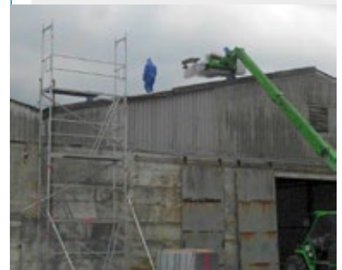
Demontage von Wellasbestplatten bei Absturzgefährdung nach außen.
