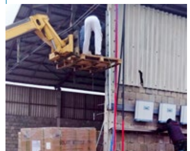
Unzulässige Personenbeförderung zu hochgelegenen Arbeitsplätzen.
