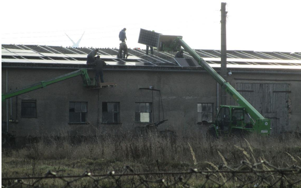
Abbildung 3: nicht arbeitsschutzgerechte Montage von PV-Modulen auf Asbestzementdach Quelle: LAGuS
