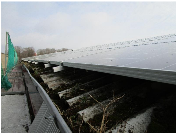
Abbildung 4: verbotene Überbauung einer Dachfläche Quelle: LAGuS
