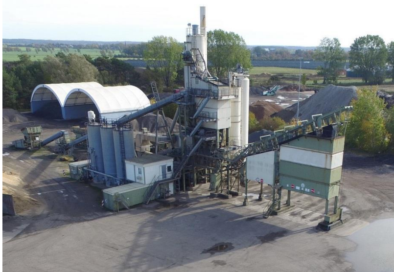
Abbildung 5: Asphaltmischanlage, Quelle: LAGuS
