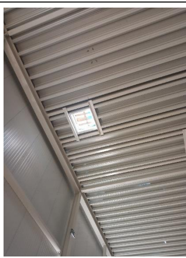
Abbildung 11: Dachöffnung mit provisorischer Sicherung nach Unfall, Blick von unten
