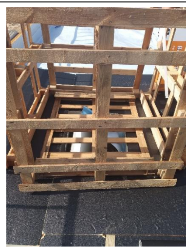
Abbildung 12: provisorische Sicherung der Dachöffnung nach Unfall
