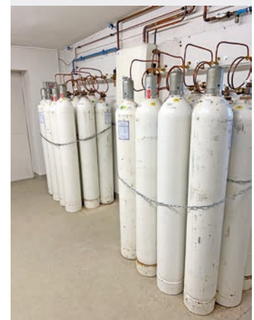
Flaschenbatterie mit Sauerstoffflaschen mit Anbindung an das Leitungsnetz des Krankenhauses
